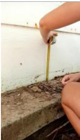
Dépôts de matières solides
