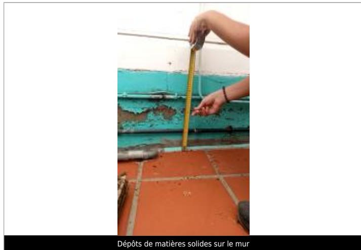
Dépôts de matières solides sur le mur
