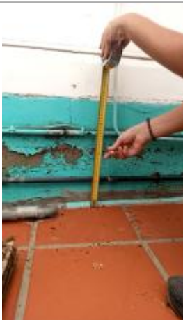
Dépôts de matières solides sur le mur
