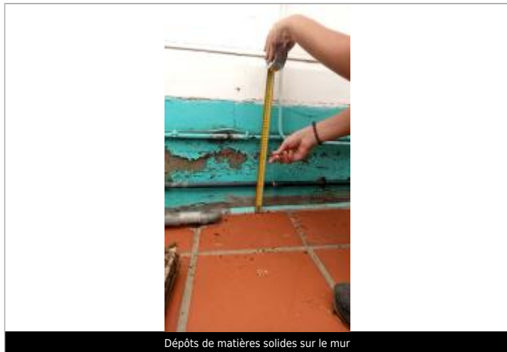
Dépôts de matières solides sur le mur
