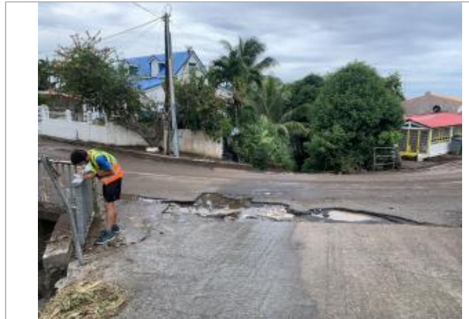
Destruction de l'ouvrage aval
