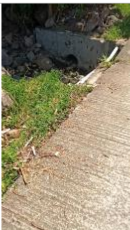
Débris de végétation, côté amont de l'ouvrage
