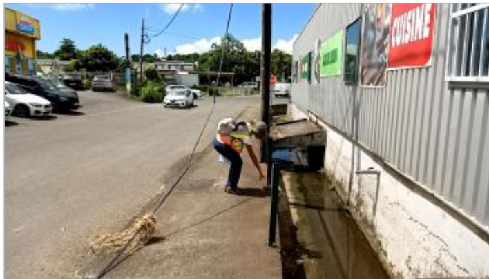
Dépôt de sédiment sur poteau
