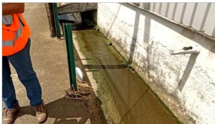
Laisse d'inondation décrivant le passage de l'eau
