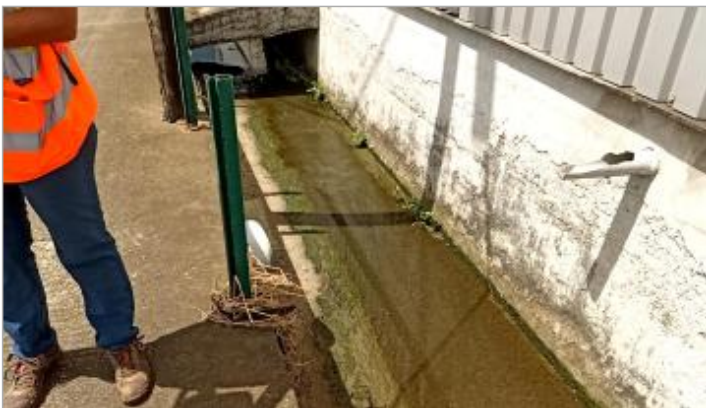
Laisse d'inondation décrivant le passage de l'eau
