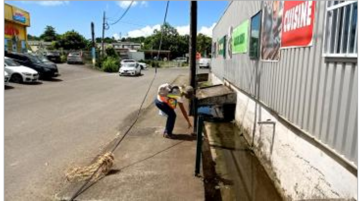
Dépôt de sédiment sur poteau
