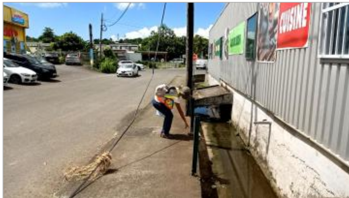
Dépôt de sédiment sur poteau
