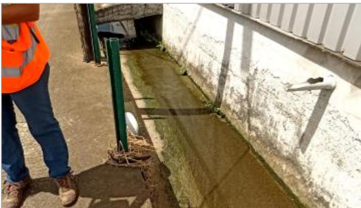
Laisse d'inondation décrivant le passage de l'eau
