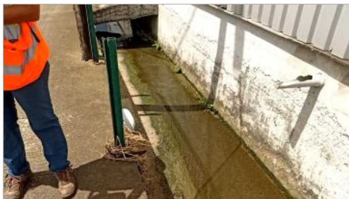
Laisse d'inondation décrivant le passage de l'eau
