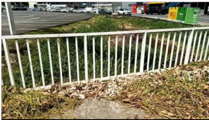
Branchages pris dans la barrière du pont
