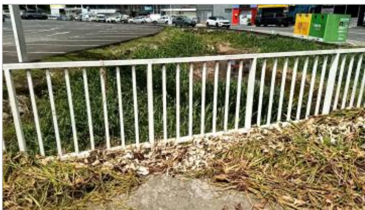
Branchages pris dans la barrière du pont
