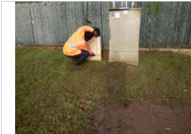
Le site est un coffret électrique
