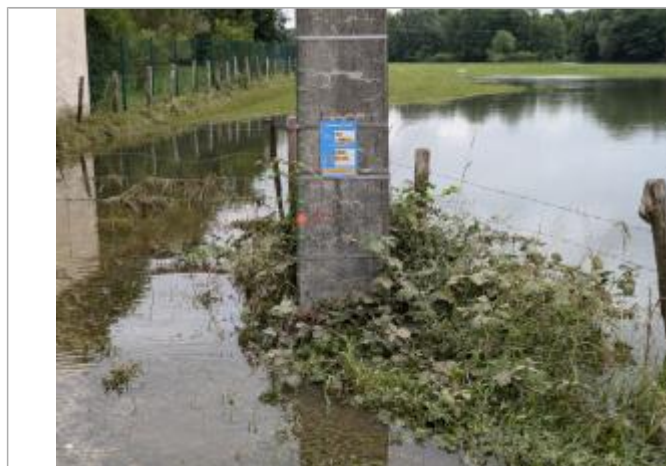
Marque peinture sur poteau EDF
