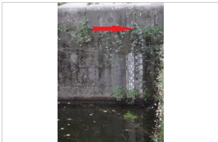
Ecluse du Mail à Rennes - échelle amont
