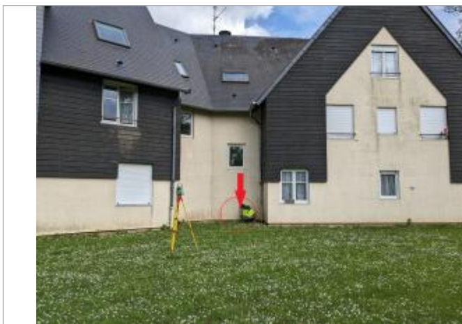
Laisse de crue à 22 cm/sol.
