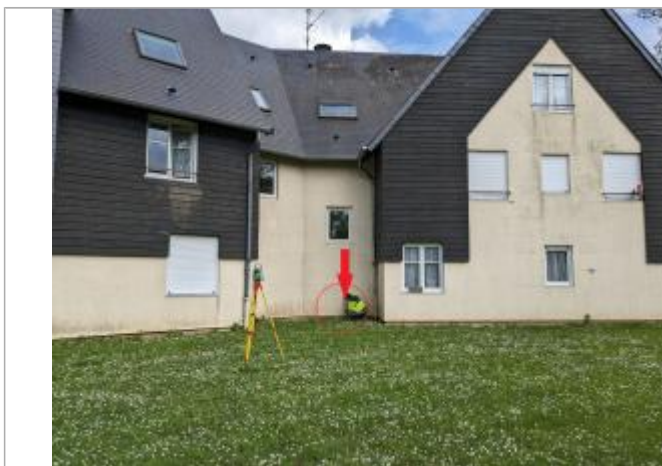
Laisse de crue à 22 cm/sol.
