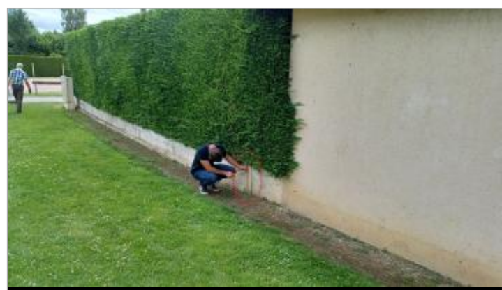
Laisse de crue à 26.5 cm/sol.
