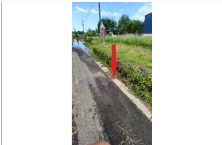
Laisse de crue au sol.
