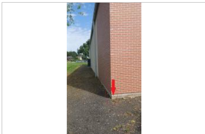
Laisse de crue à 13.5 cm/sol
