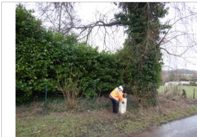
Le site est un coffret électrique
