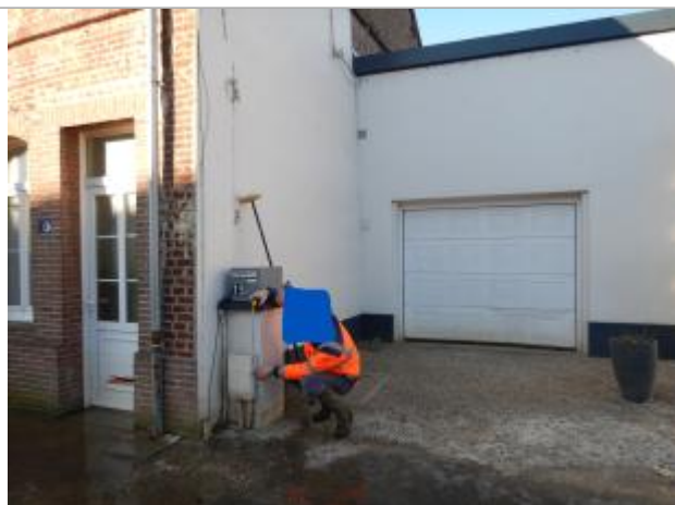
Repère localisé sur un coffre électrique
