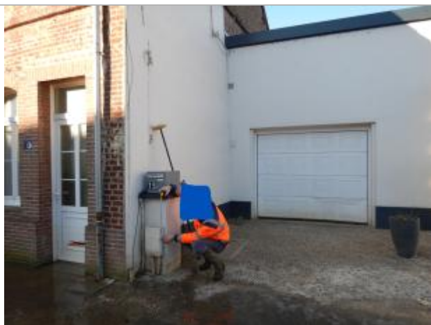
Repère localisé sur un coffre électrique
