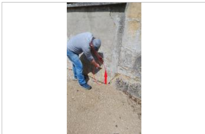
Laisse de crue à 42 cm/sol.
