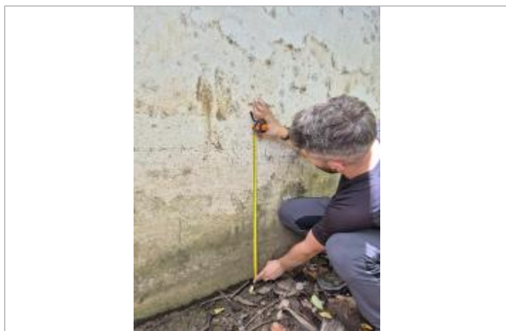
Dépôts matières solides
