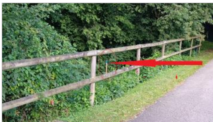
Laisse de crue au sol
