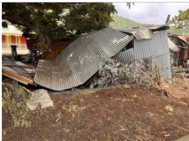
Maison détruite par les vagues
