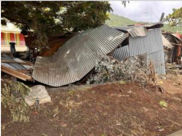
Maison détruite par les vagues
