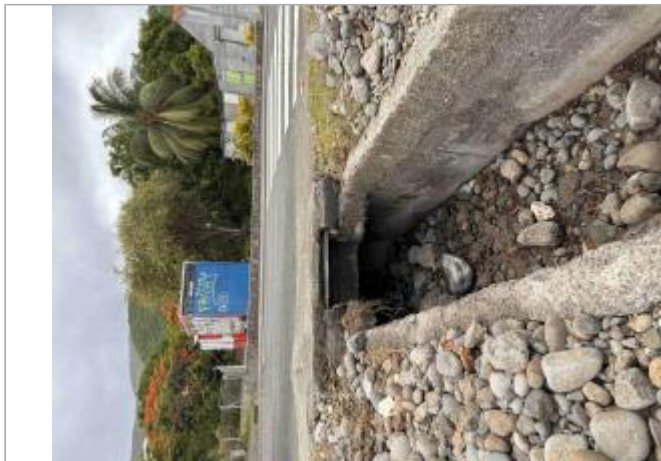
Inondation jusque sur la route et buse encombrée par des dépôts (galets, sables)
