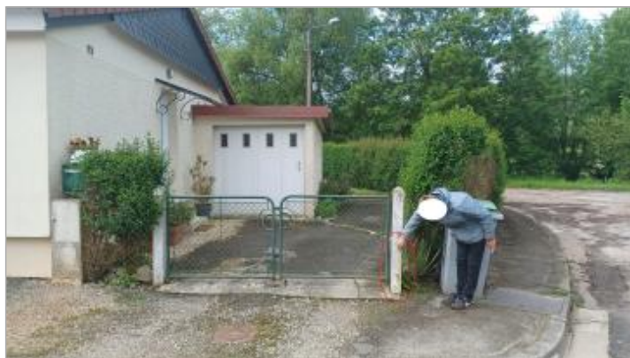
Laisse de crue à 30 cm/sol
