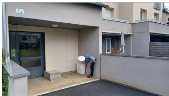
Laisse de crue à 17.5 cm/sol
