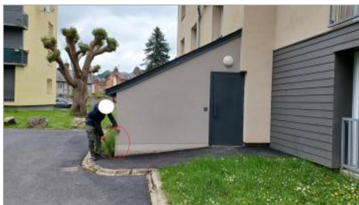
Laisse de crue à 35 cm/sol.
