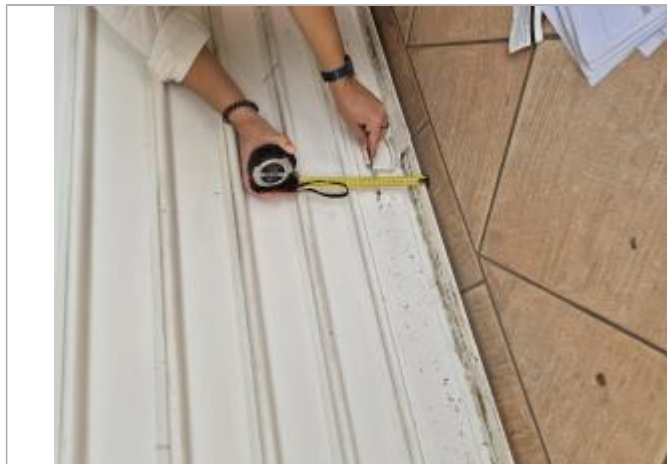
Dépôts de matières solides
