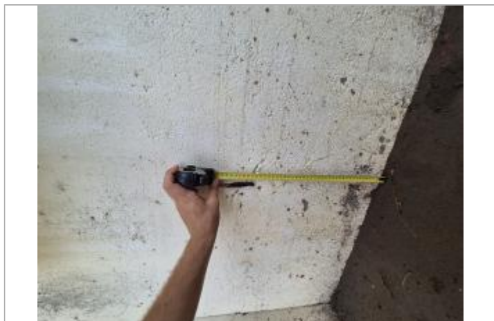
Dépôts de matières solides
