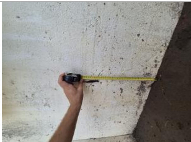
Dépôts de matières solides
