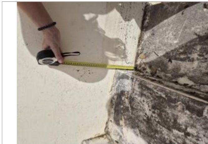
Dépôts de matières solides
