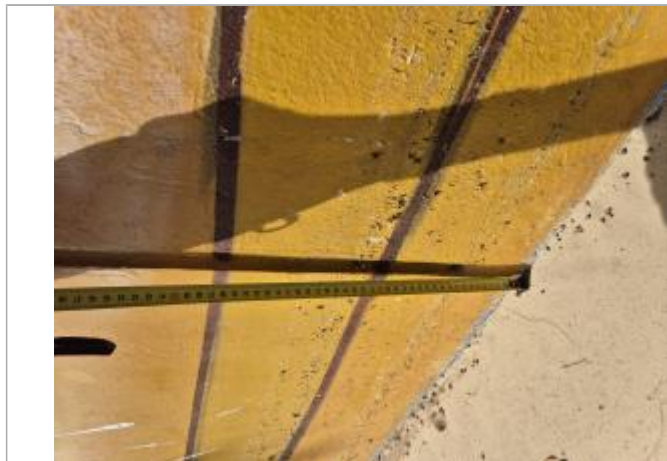
Dépôts de matières solides
