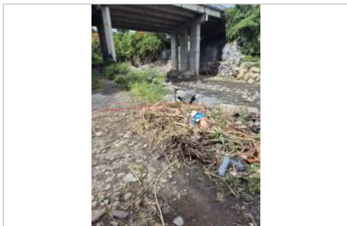
Dépôts de matières solides
