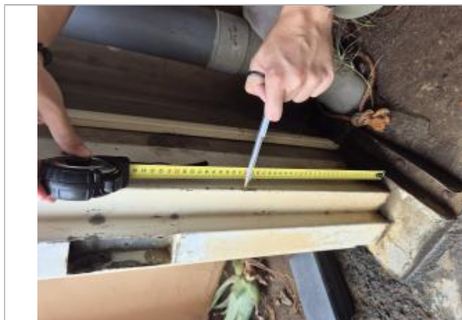
Dépôts de matières solides
