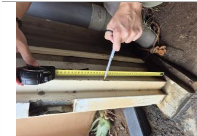
Dépôts de matières solides
