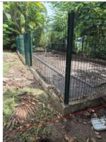
Emprise de la zone inondée au niveau de l'infrastructure (côté portillon)
