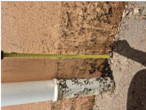
Dépôts de matières solides
