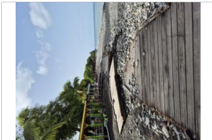
Destruction du ponton piéton en bois
