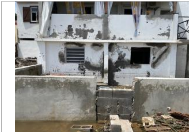
dépôt de matière solide sur le mur façade littorale
