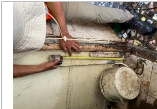
dépôts de matières solides
