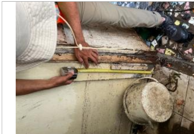
dépôts de matières solides
