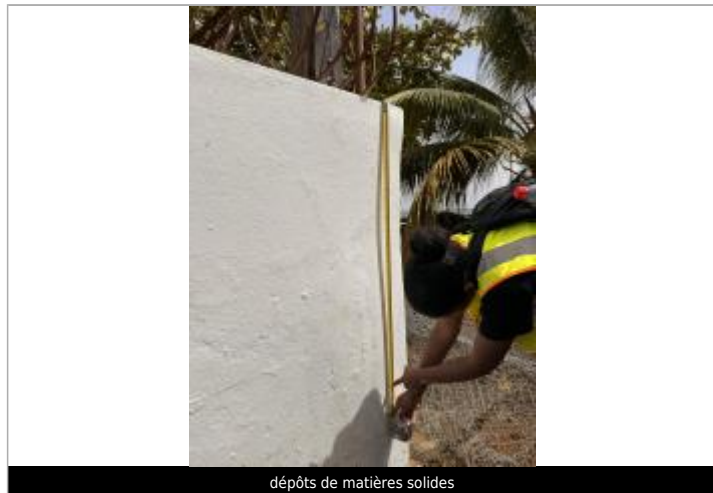
dépôts de matières solides
