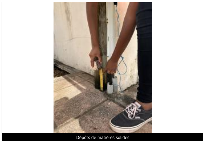
Dépôts de matières solides
