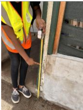
témoigne de la hauteur d'eau sur muret extérieur
