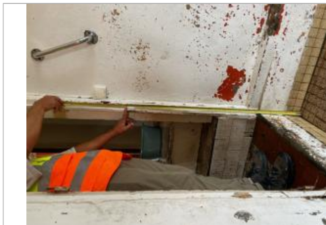
Témoignage hauteur atteinte par l'eau
