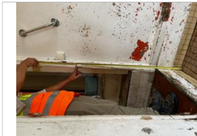
Témoignage hauteur atteinte par l'eau
