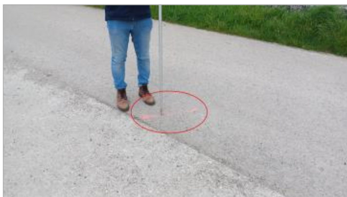
laisse de crue au sol
