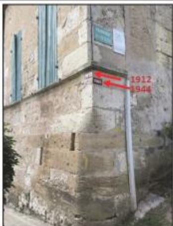
Photo du repère - Auteur : DHE
