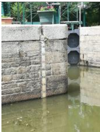
Echelle limnimétrique aval de l'écluse de la Maclais
